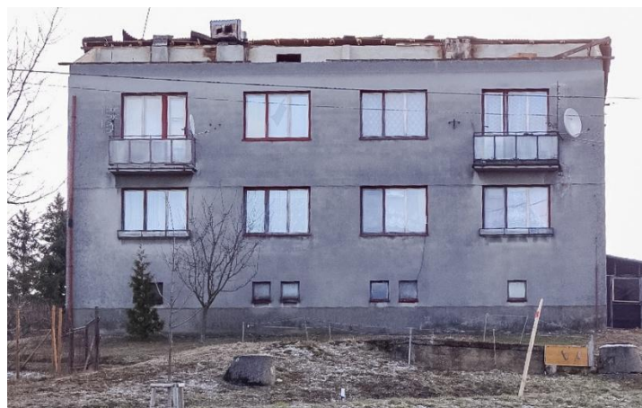
Dům čp. 24 ve Vlčkovcích po řádění orkánu Eberhard (foto: 11. 3. 2019)
